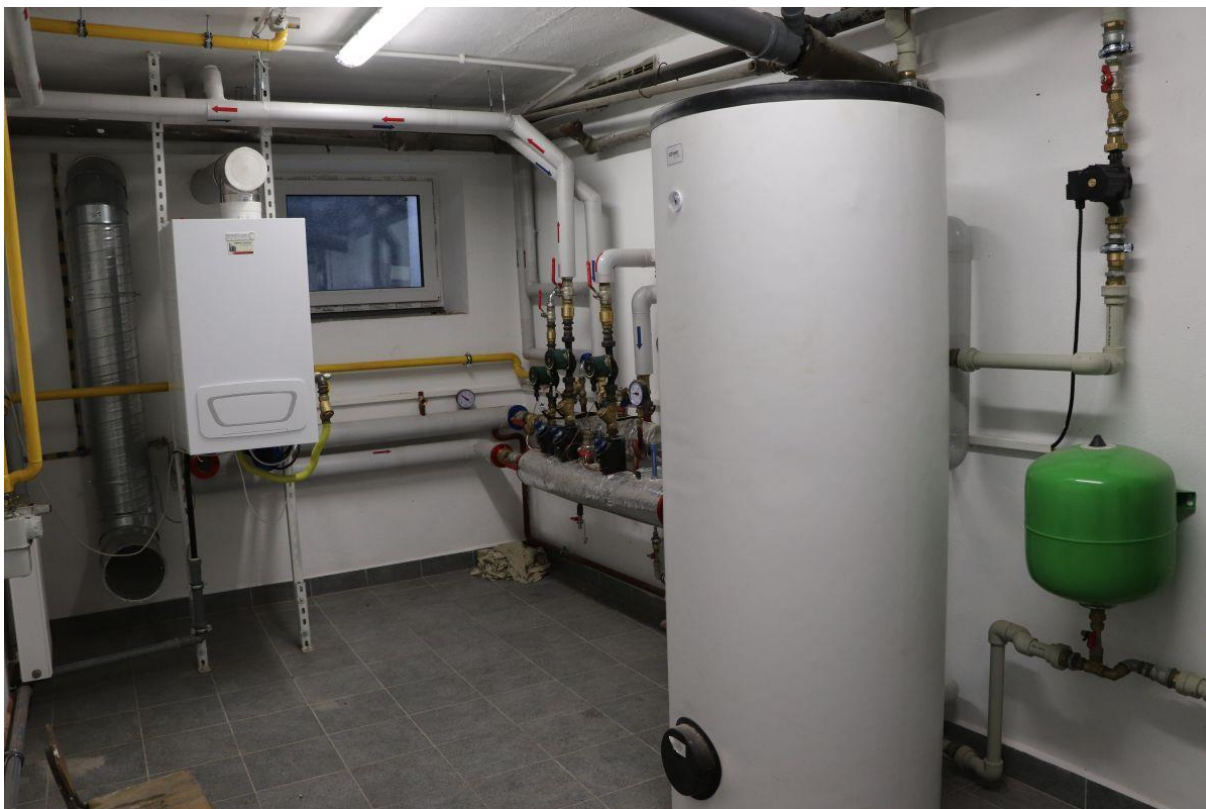
Nowa kotłownia zasilana gazem ziemnym
