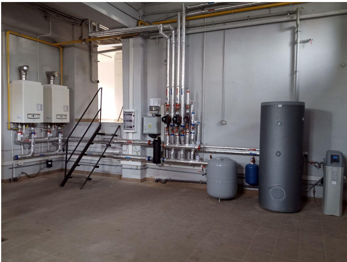
Nowa kotłownia zasilana gazem ziemnym
